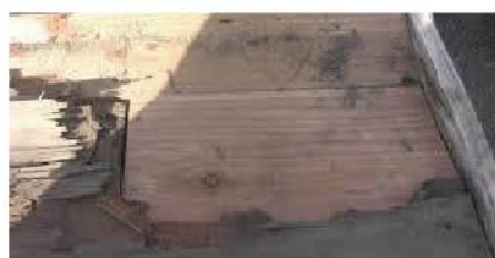
サビが広がり表面が剥がれている屋根…こうなると塗装ができなくなってしまいます。
