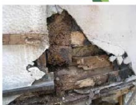
雨漏りで木部が腐食した壁の内部
